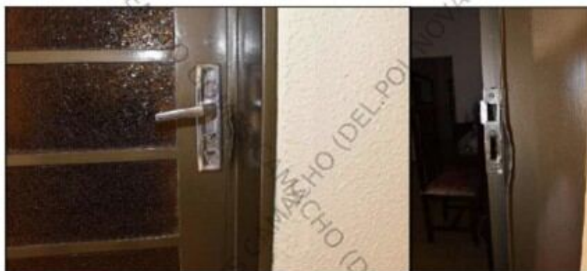
Figura 2. Detalhe dos vestígios de arrombamento da porta de vedação da sala.
