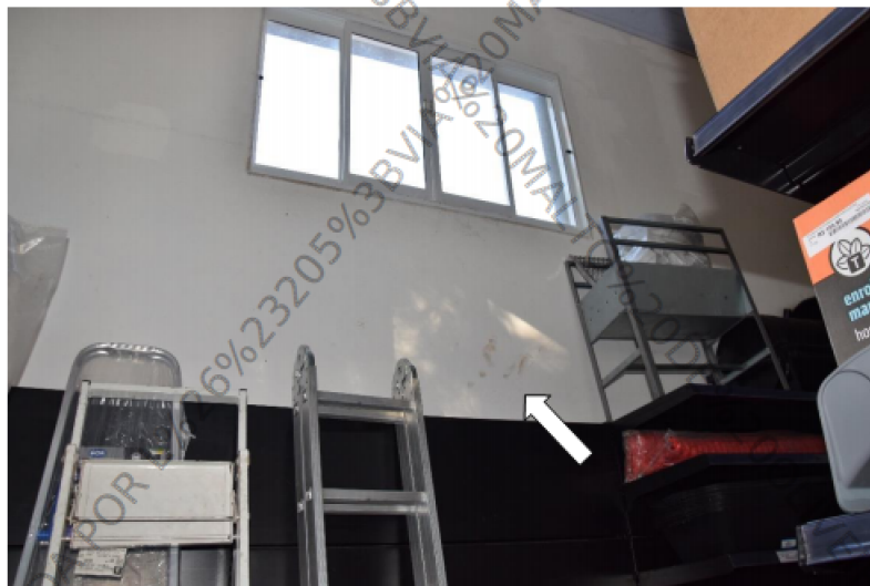
Visão de vestígio de escalada na parede interna da janela do estabelecimento.
